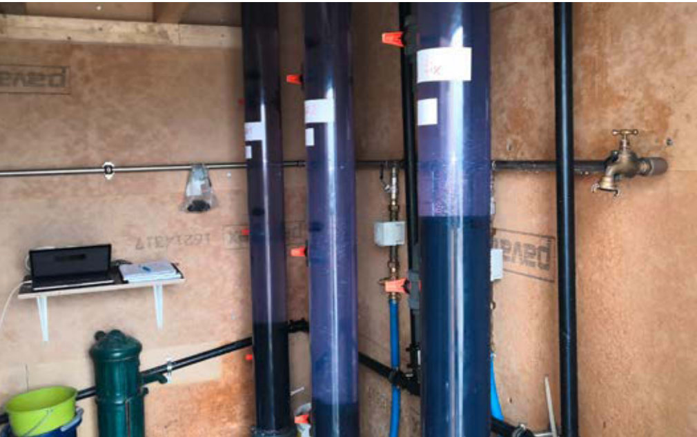
Les filtres au puits de la Vernaz.
