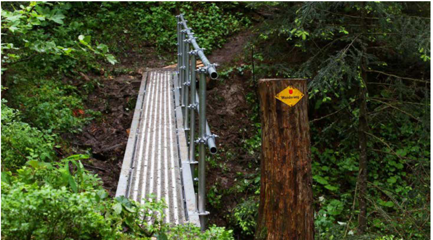
Die neuen Brücken in Rothenthurm sind dauerhaft, rutschfest und erfordern weniger Unterhalt.
