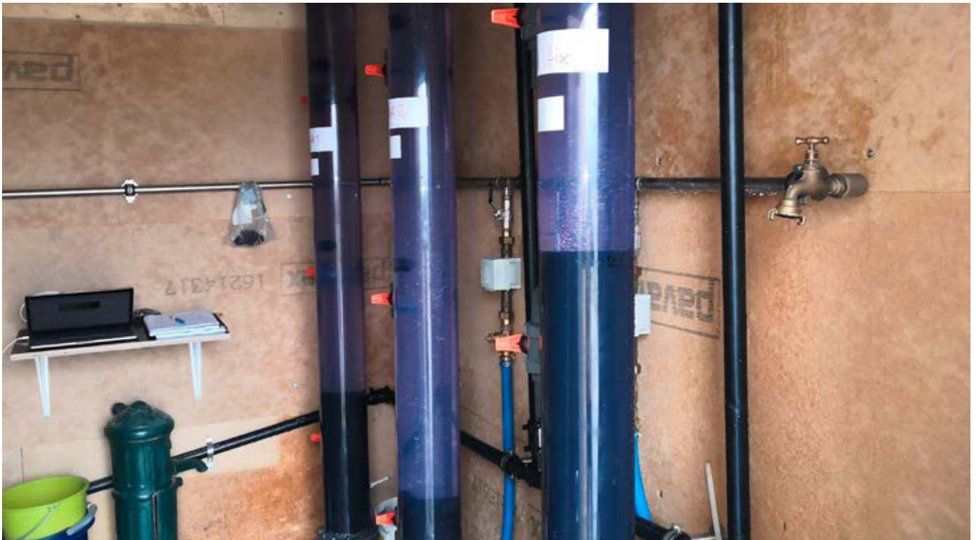
Der Filter beim Brunnenschacht von La Vernaz.
