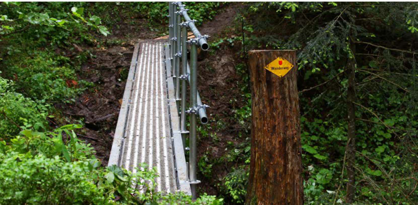
A Rothenthurm, les nouveaux ponts sont durables, antidérapants et nécessitent moins d'entretien.
