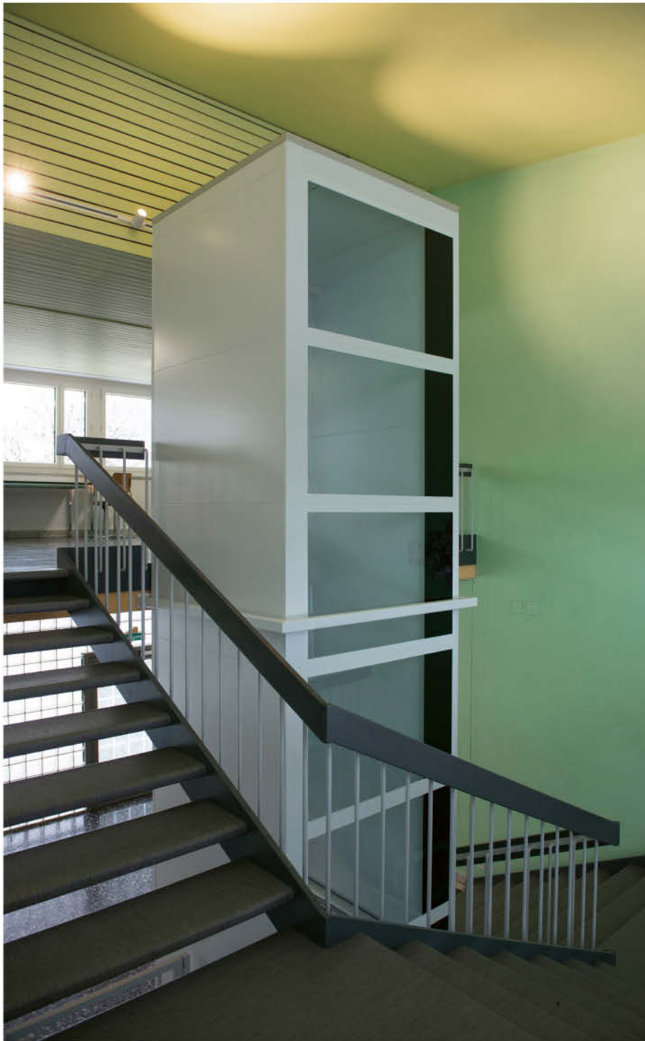
Der neue Vertikallift hilft Robin, die Schulgeschosse im Rollstuhl zu bewältigen.
