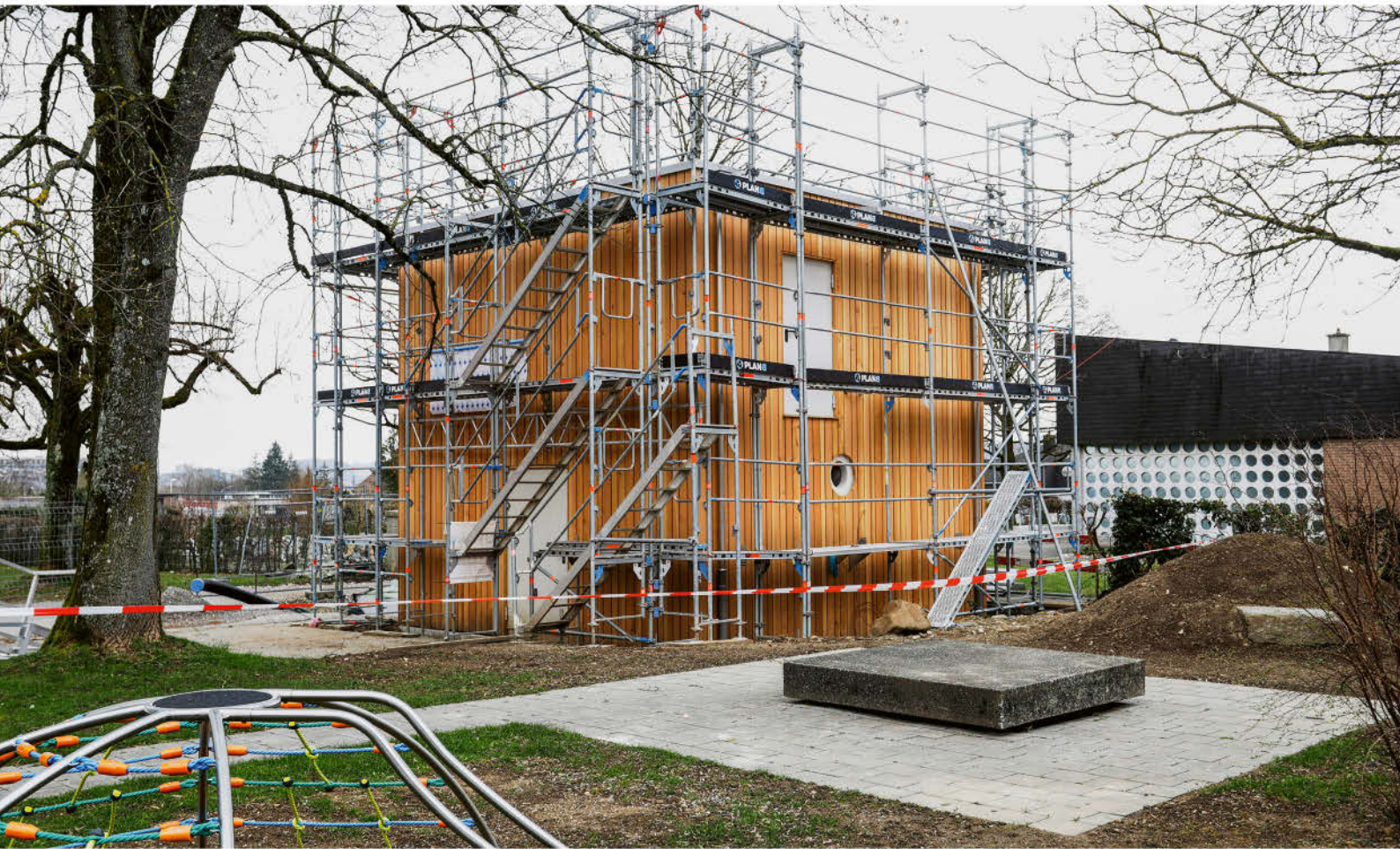
Die neue Heizzentrale der Gemeinde Bellach.
