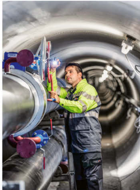
Der Heiligbergstollen versorgt das Gebiet Sulzer Stadtmitte mit Abwärme von der KVA.
