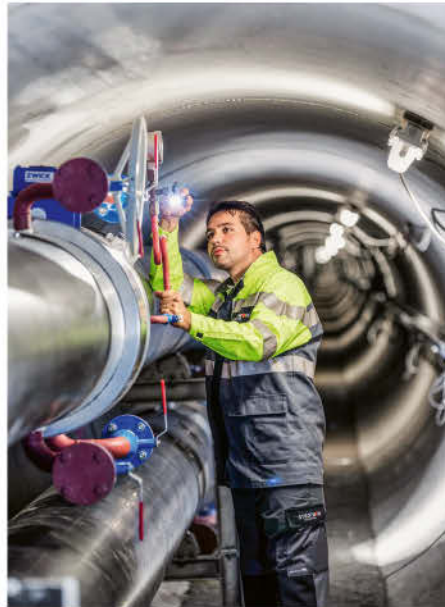
Le tunnel de Heiligberg alimente la zone de Sulzer Stadtmitte.
