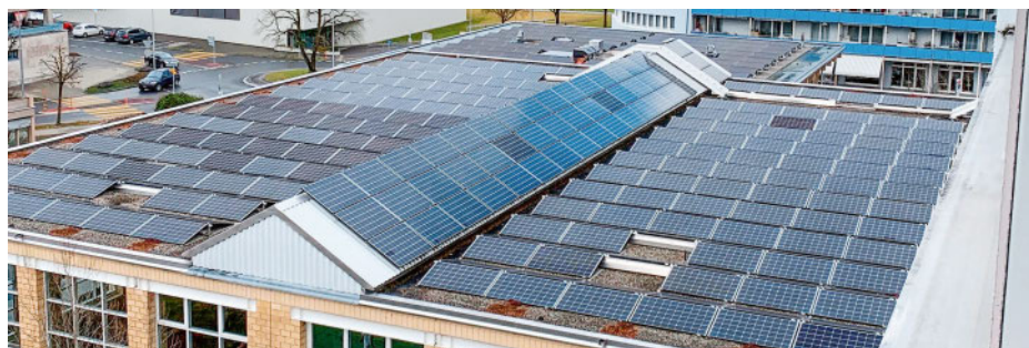
Blick auf die Fotovoltaikanlage auf dem Dach der Turnhalle. Das Schulareal Waldegg wurde für einen Zusammenschluss zum Eigenverbrauch (ZEV) umgerüstet; weitere Anlagen sind geplant.
